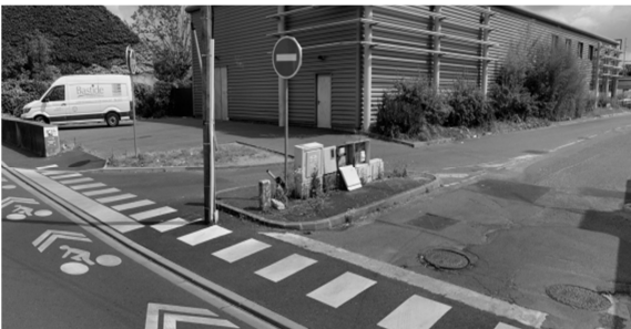
Fig.9 - coffrets électriques situés sur un îlot de circulation en entrée de zone
